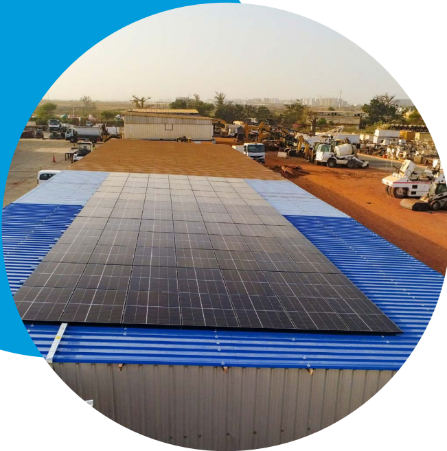
■ Panneaux solaires installés à l'usine d'Eiffage Sénégal
